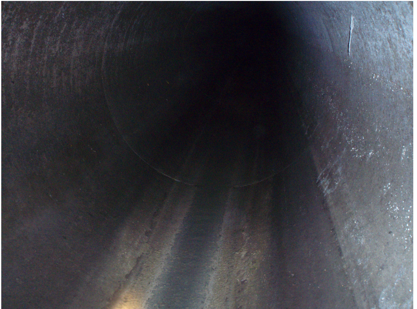
Bild 10,11 u. 12: Stauraumkanal nach 48 Stunden automatischem Spülbetrieb ( 4 Wellen mit ca. 12 m 3 in 24 Stunden)
