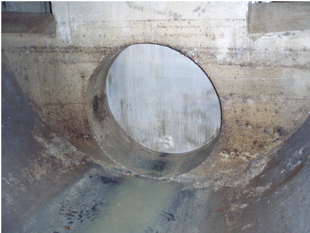
Bild 6: geschlossenes Spülaggregat von Unterwasserseite
