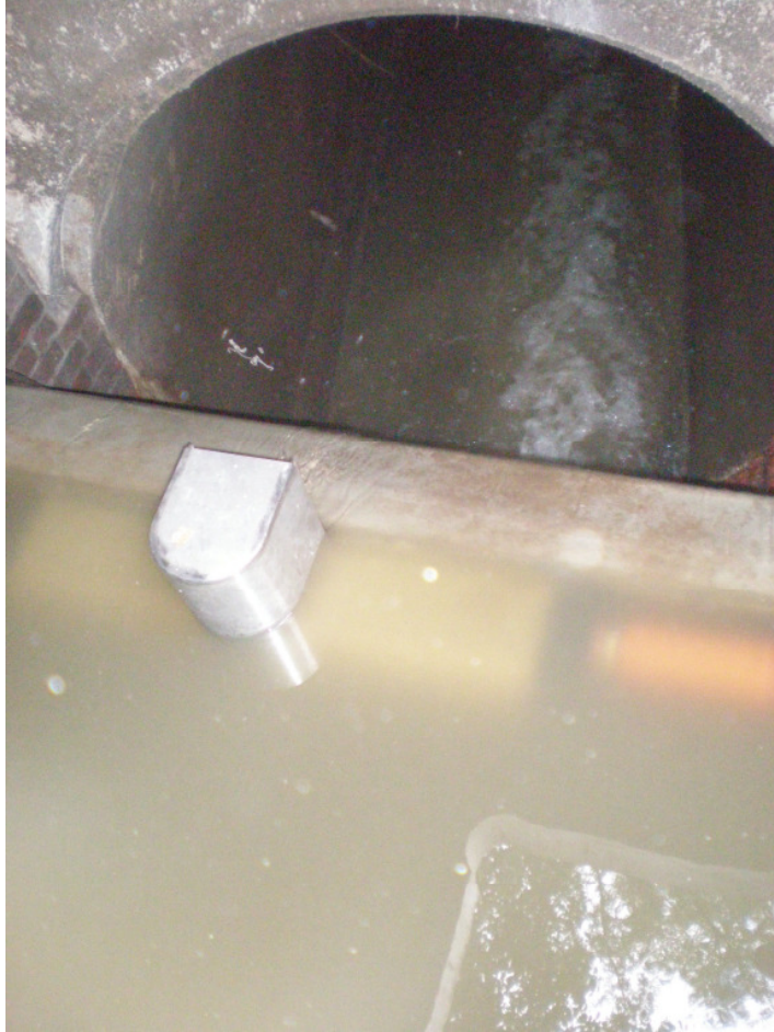
Bild 5: mit Schmutzwasser eingestautes Spülaggregat
