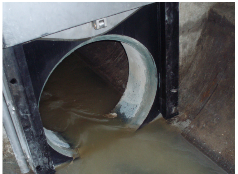
Bild 3 und 4: vollgeöffnetes Spülaggregat bei Trockenwetterabfluss
